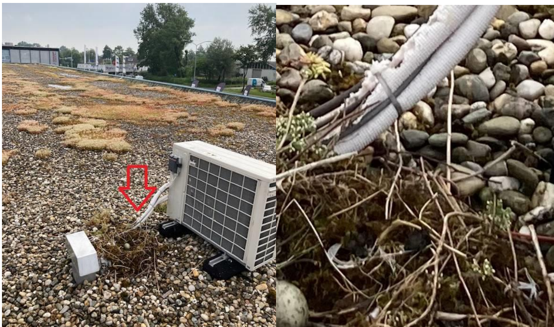
Figuur 19: Aangepikte isolatie rondom stroomkabels airco bedrijfspand (foto: R.J. Buijs)
