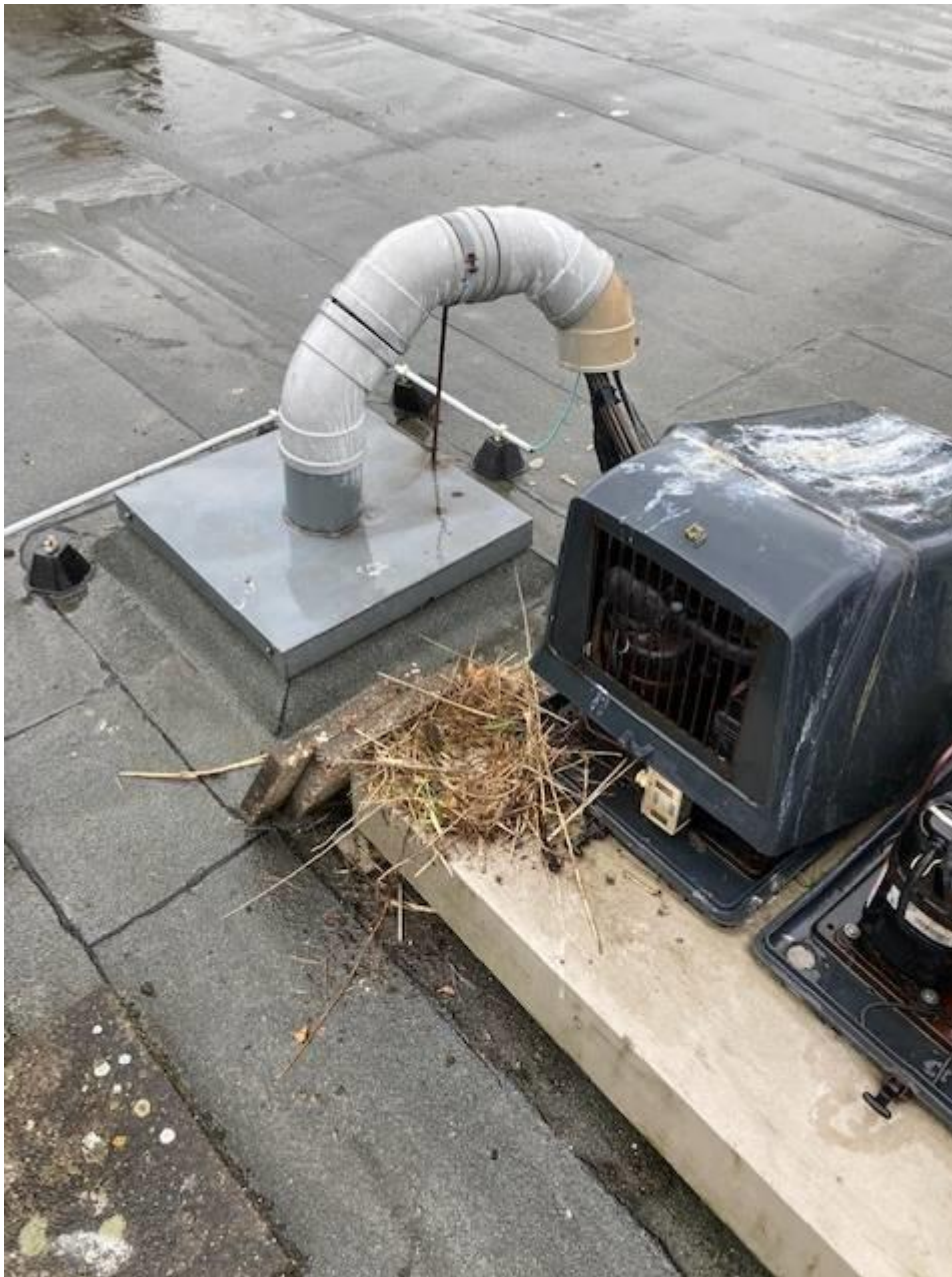
Figuur 20: Meeuwenontlasting en nestmateriaal op dakinstallatie (foto: R.J. Buijs)
